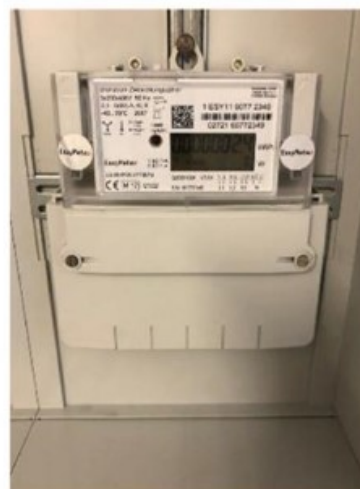
Stromzähler Bitte gut sichtbares Foto machen
