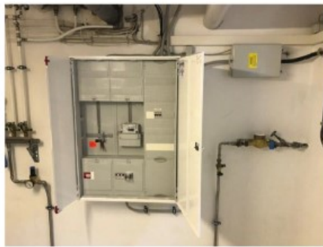
Aus der Entfernung - Zählerschrank
